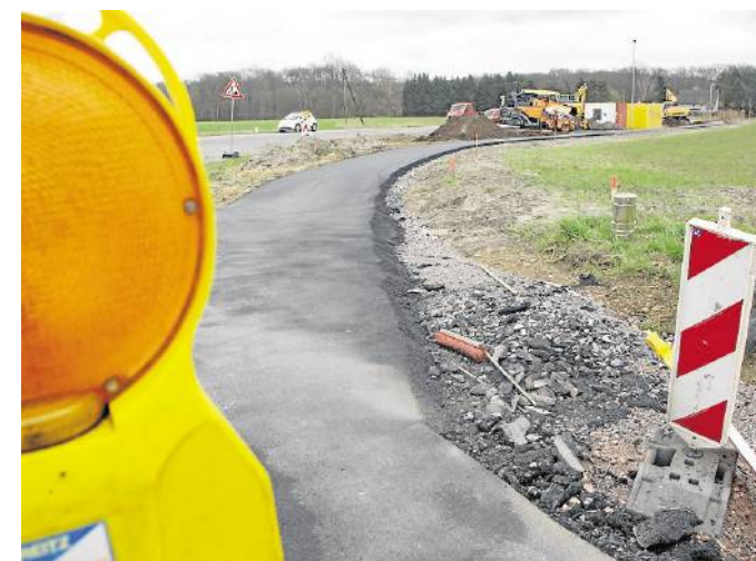
Wegen der Asphaltarbeiten an der Einmündung in den Westenhellweg ist die Jahnstraße ab heute Einbahnstraße. Foto: Milk
