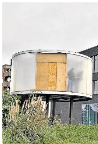
Der Sturmsschaden an der „Waschtrommel“. FOTO: DRAWE
